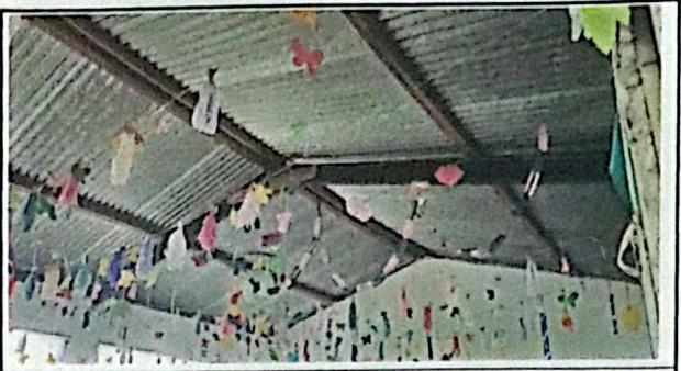
Foto 3: los soportes de las laminas no son las adecuadas para el peso de las mismas.
