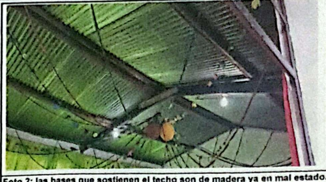
Foto 2: las bases que sostienen el techo son de madera ya en mal estado.
