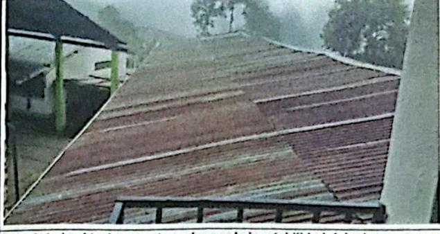
Foto 4: todo el techo ya esta curbo por la inestabilidad del mismo.
