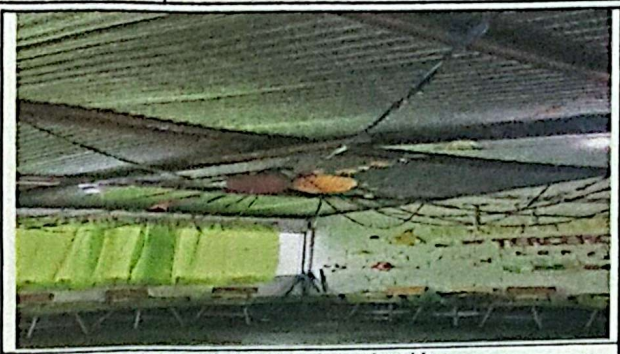
Foto 1: el techo del modulo 2 esta en riesgo de caída.
